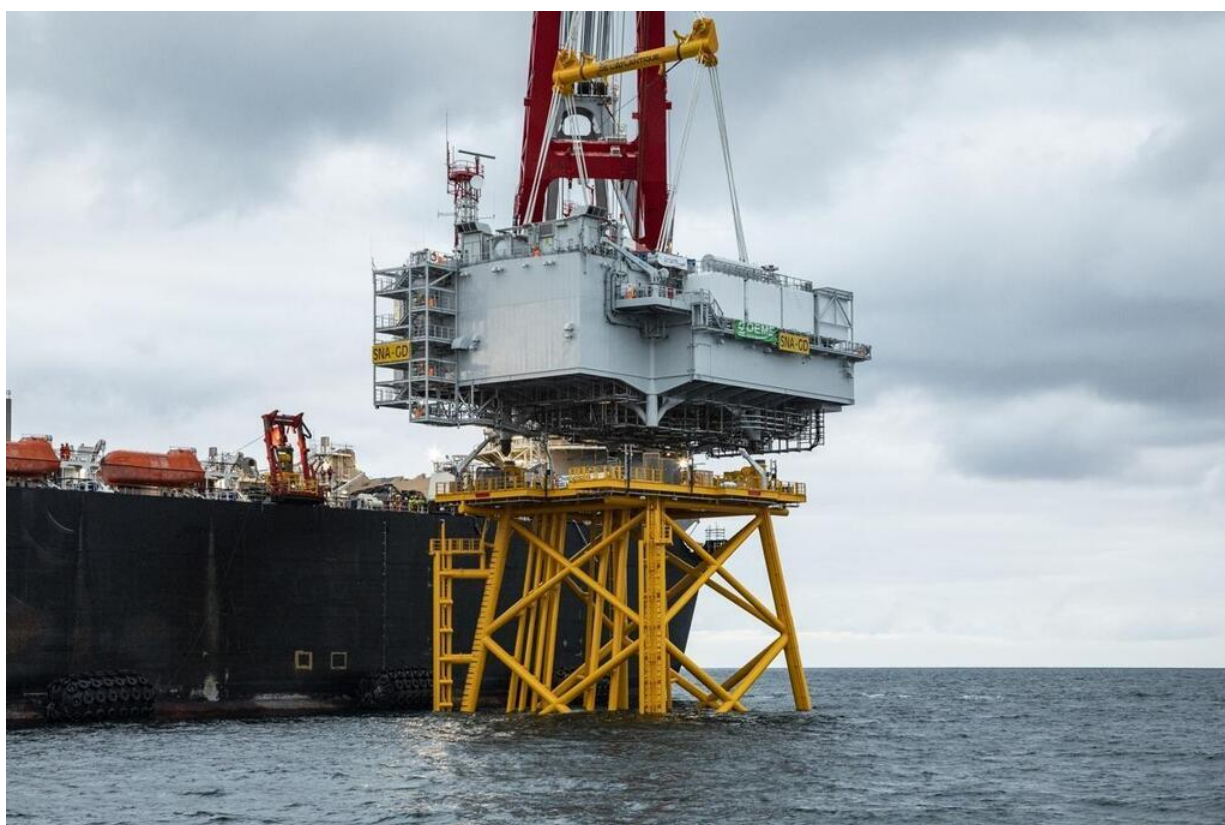
Installation au large de Saint-Nazaire de la sous-station électrique construite par les Chantiers de l'Atlantique, en août 2021 (© Allseas – Van Der Kloet)
